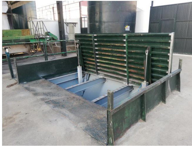
Figura 5.3 Terminal de descarga a tolva de recepción.
