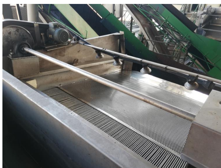
Figura 5.6 Zona de lavado y despallado.
