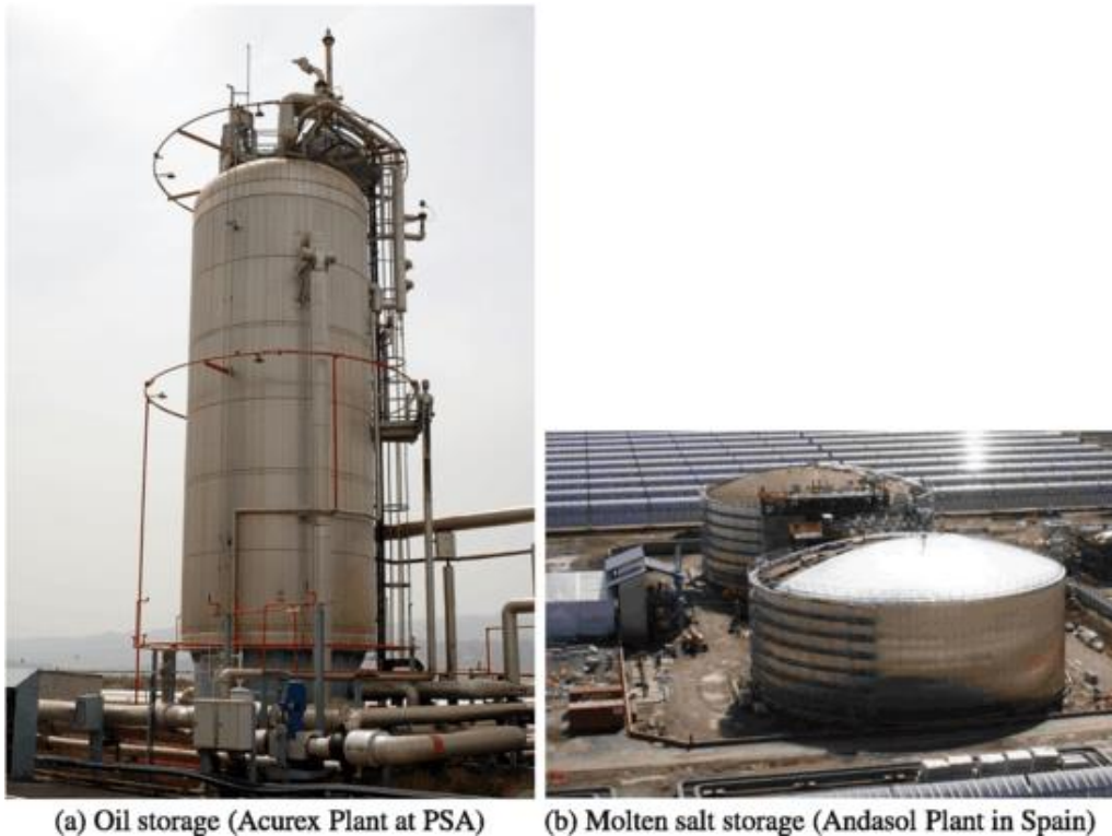
Fig. 1.3: Tanque de almacenamiento del campo solar Acurex [1].
