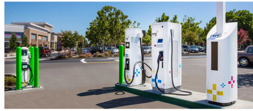
Figura 1.16 Estación de carga pública.
