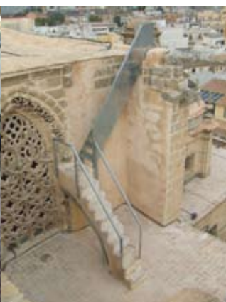
02/10/2007 Cubierta Capilla del Cristo de la Salud. Estado final. Foto: Taller de Inmuebles, IAPH
