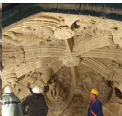
01/01/2006. Visita de obra: Intervenciones en la Capilla del Socorro. Foto: Taller de Inmuebles, IAPH
