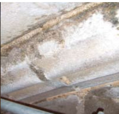
16/05/2007. Eflorescencias. Foto: Taller de Inmuebles, IAPH
