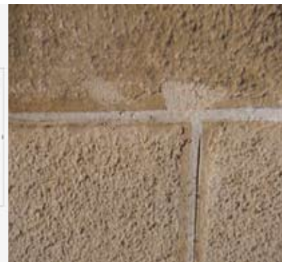
14/02/2007. Humedades de condensación. Foto: Taller de Inmuebles, IAPH
