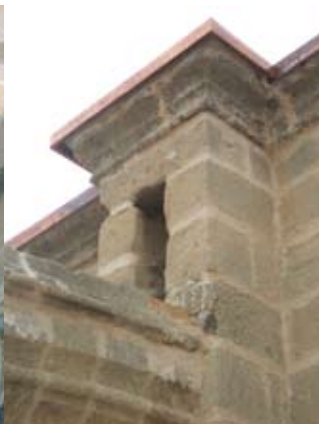
02/10/2007 Ejecución de remate de pretilos en chapa de cobre. Foto: Taller de Inmuebles, IAPH
