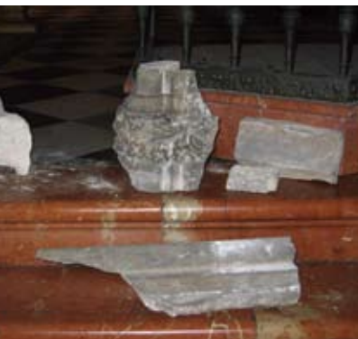
24/02/2004. Piezas desprendidas: nervaduras y elementos decorativos de las vidrieras. Foto: Taller de Inmuebles, IAPH
