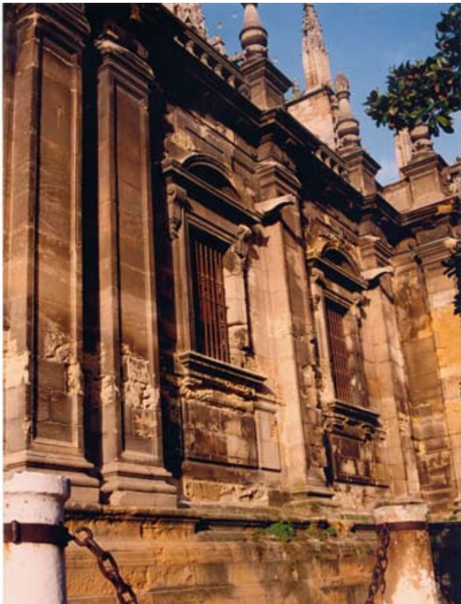
Estado de alteración que presentaba el módulo B de la fachada sur en 1996, con sillares que muestran importantes pérdidas de material, picados, descohesiones y bioalteraciones. Foto: Francisco Pinto Puerto
