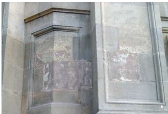
Detalle del estado que presentaba un paramento de la esquina de los módulos C y D en 2001 (a), anterior a la tercera fase de intervención, y en 2003 (b). Fotos: Carmen Enríquez Díaz (a) y María Gracia Gómez de Terreros (b)
