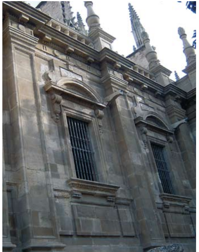
Estado de alteración que presentaba el módulo B de la fachada sur en 2004, donde aparecen lesiones de menor gravedad: variaciones en el aspecto, coloración superficial y ligeros picados. Foto: María Gracia Gómez de Terreros
