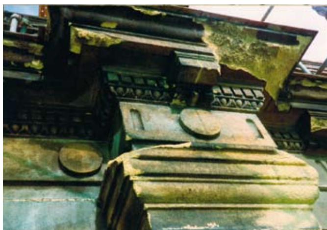
Detalles de zonas con pérdidas de volúmenes decorativos. Estado previo a la intervención 1993-1996. Fotos: Francisco Pinto Puerto
