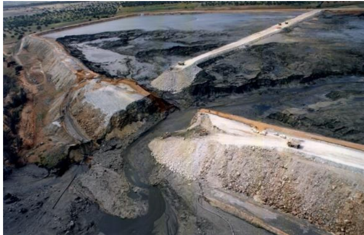
Figura 4-2. Rotura del dique de contención. Accidente de Aznarcóllar.
