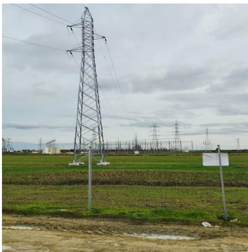
Tramo aéreo de la línea de alta tensión
