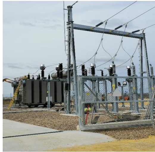
Pórtico de salida de línea en “Don Rodrigo II”
