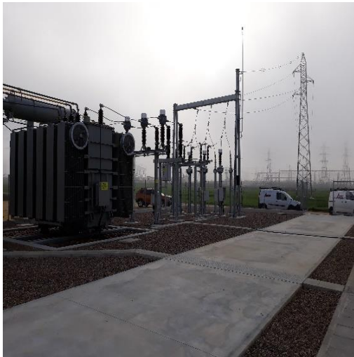
Bahía de la subestación y línea de alta tensión
