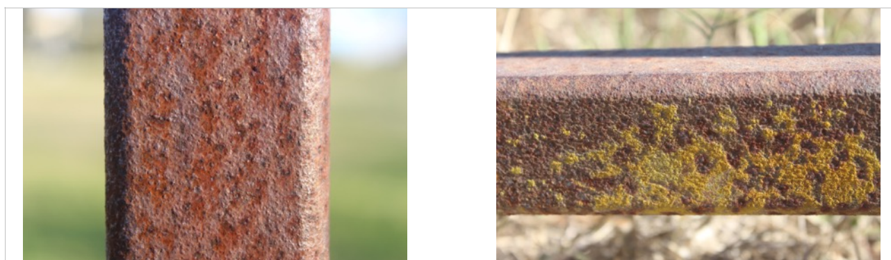
Figura 13 y 14. Figura 13 (izquierda), corrosión en el armazón de la escultura. Figura 14 (derecha), líquenes.
