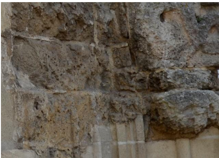
Imagen 27. Craterización en las uniones de los sillares.
