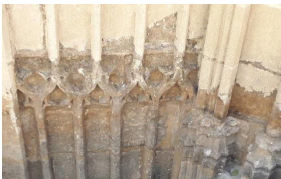
Imagen 24. Microdescamaciones en la superficie de la piedra.
