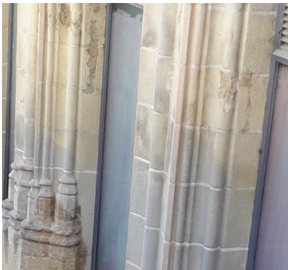
Imagen 29. Efecto de mojado por la concretación de humedad
