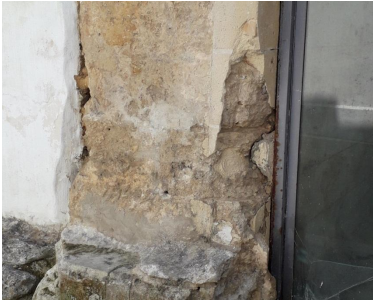
Imagen 23. Pérdida pétreo por estallido
