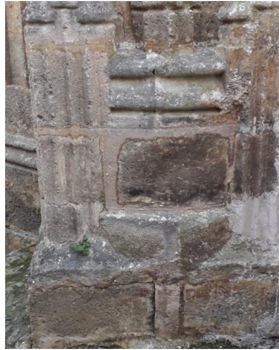
Imagen 32. Subflorescencias y descamación.
