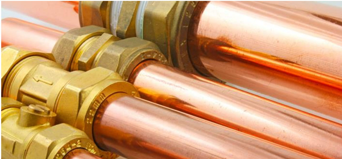
Figura 2-5. Detalle de varias tuberías de cobre
