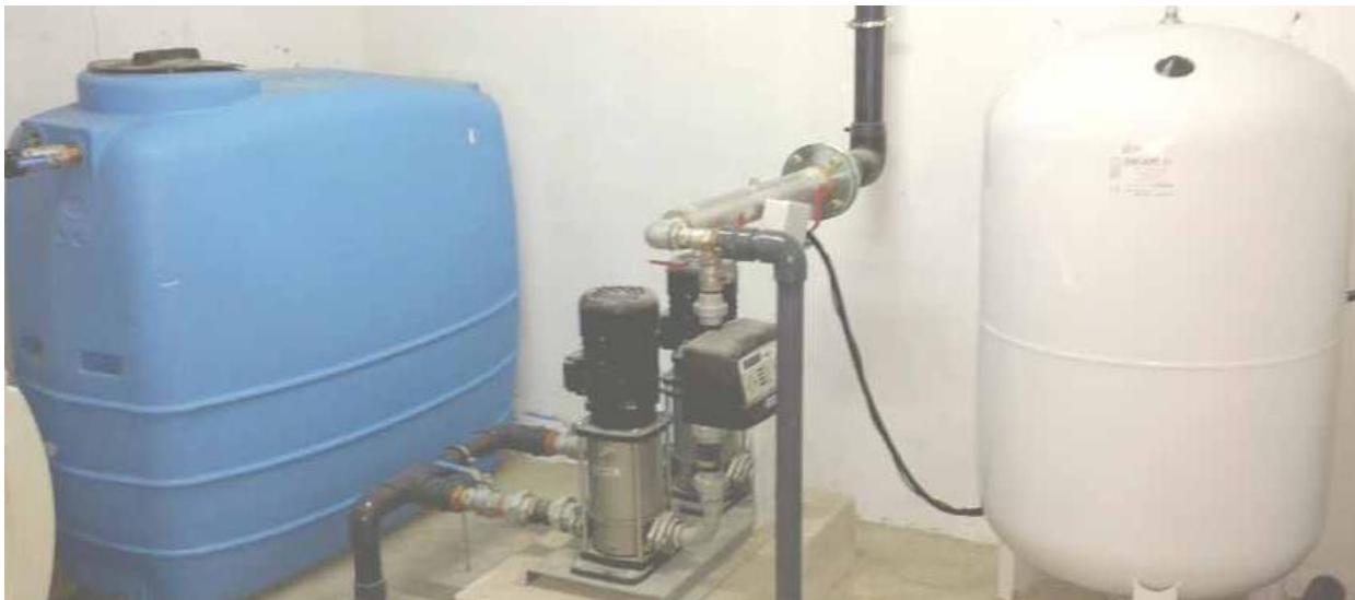
Figura 2-10. Detalle de un grupo de presión donde se observa un depósito acumulador (azul), un depósito de presión (blanco) y dos bombas centrífugas (negro)
