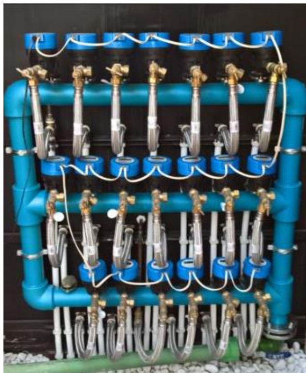
Figura 2-2. Batería de contadores divisionarios
