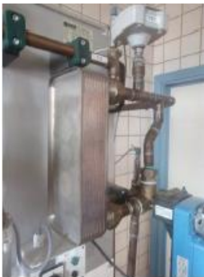
Figura 1.8: Intercambiador de calor
