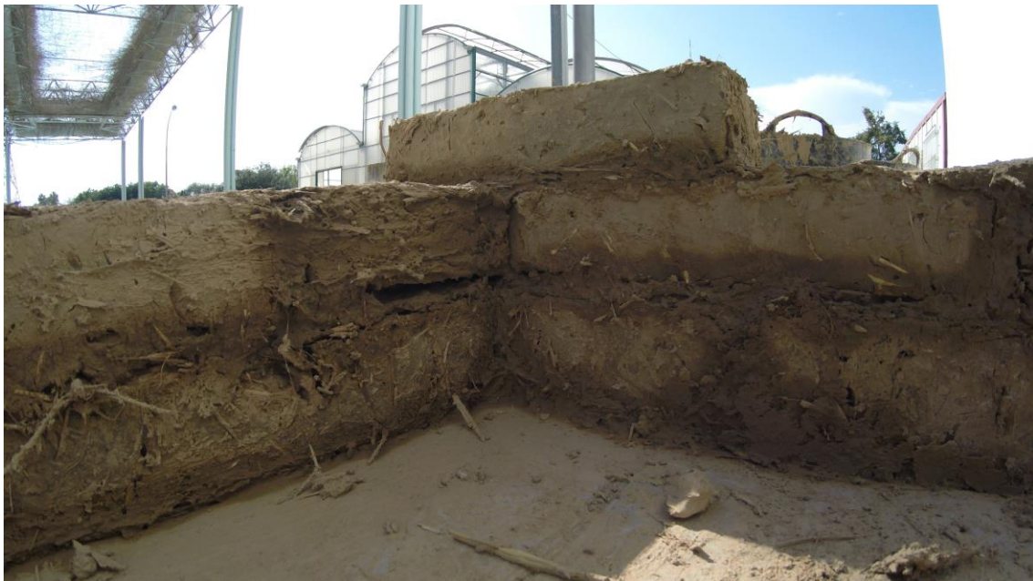
Ilustración 66 - Ladrillos de Adobe sobrepuestos. Fuente propia.
