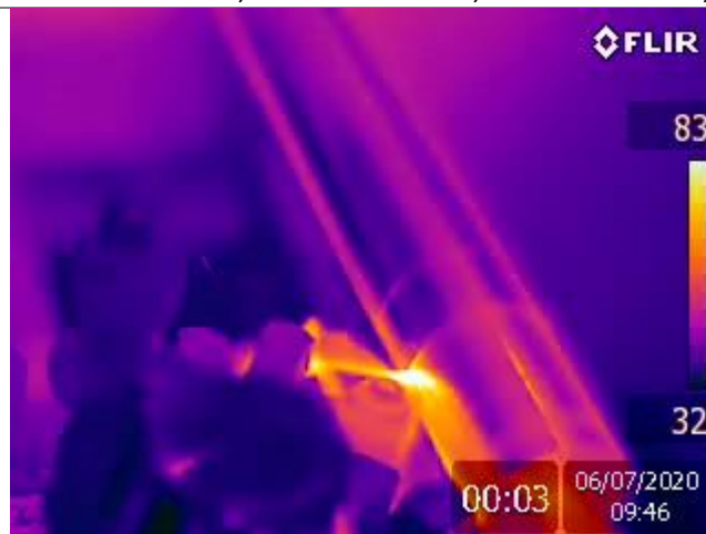
Figura B.17 Imagen térmica del ensayo 2.17
