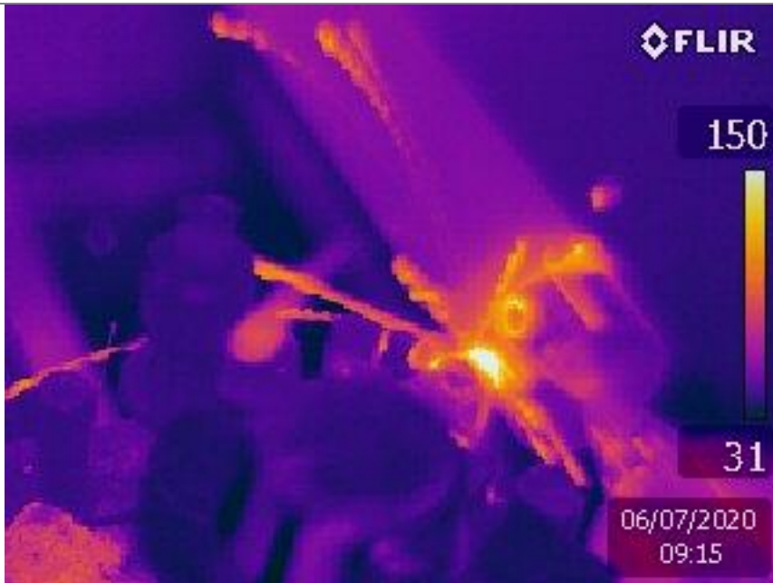
Figura B.1 Imagen térmica del ensayo 2.1
