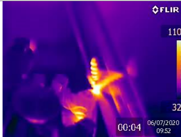
Figura B.21 Imagen térmica del ensayo 2.21
