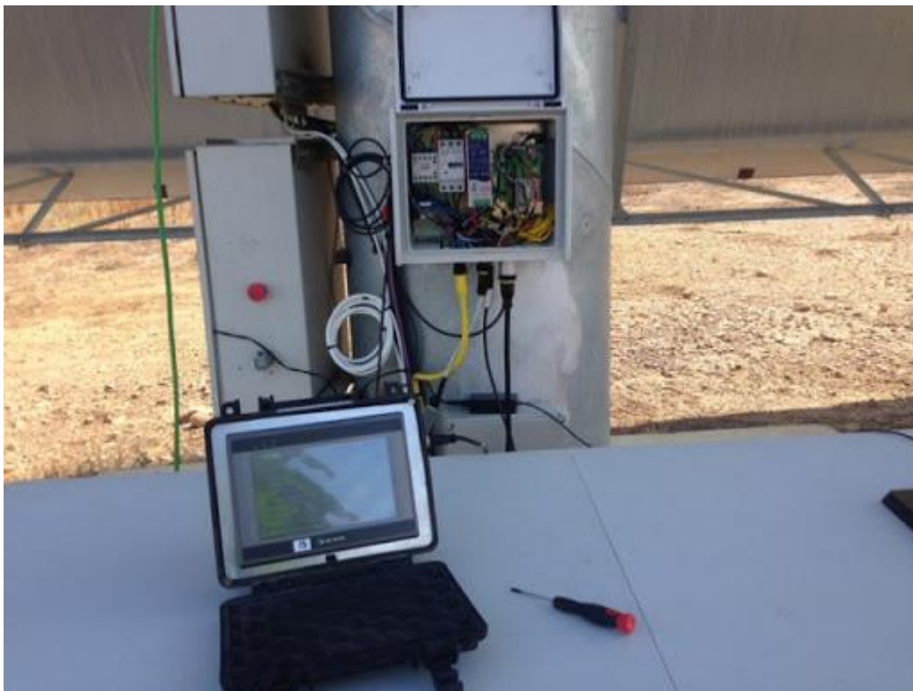
Ilustración 16: Sistema de control en heliostato. Fuente: Laenergíadelcambio.com.
