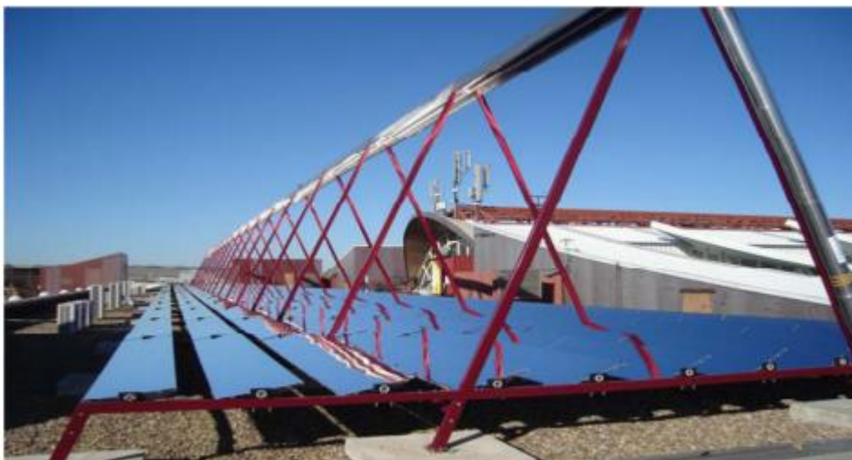
Ilustración 4: Colector Fresnel ubicado en la cubierta de la ETSI en Sevilla. [2]
