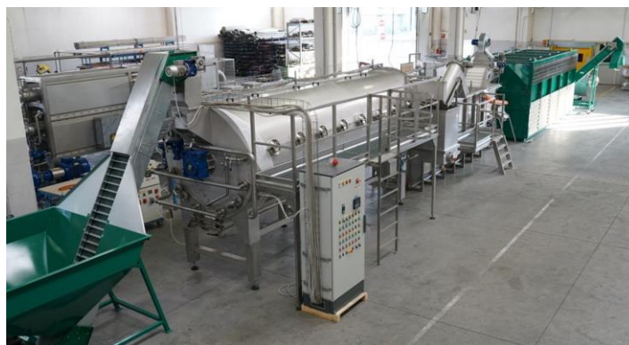
Figura 6-1. Línea de esterilizado.
