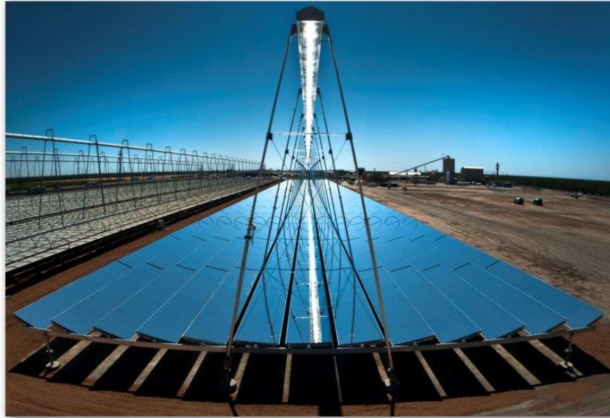
Figura 1-4.- Planta solar fresnel. [4]
