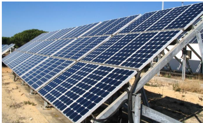
Figura 3-13. Placas fotovoltaicas con estructura metálica de soporte con inclinación fija[38]
