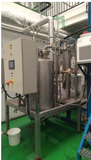
Figura 8. Reactor inyección de vapor
