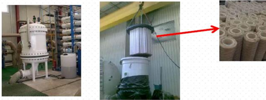
Figura 3.9 Sistemas de filtración sobre cartuchos
