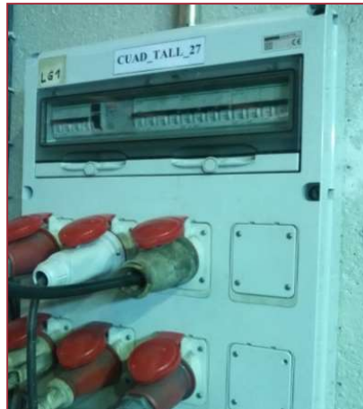
23. Cuadro eléctrico n°27 en FAB-T.
