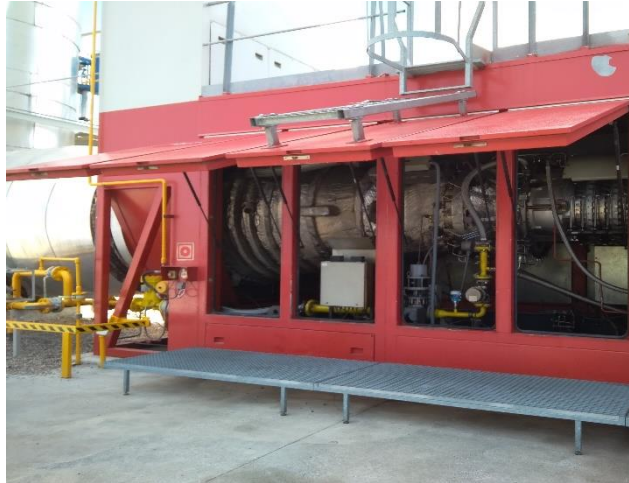
Turbina generadora de energía eléctrica y térmica con gas natural (Sacyr, Puente Genil). Marta Sánchez-Migallón.
