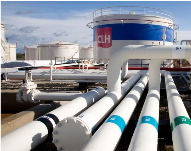
Figura 7. Instalación de almacenamiento de hidrocarburos (diario16.com)
