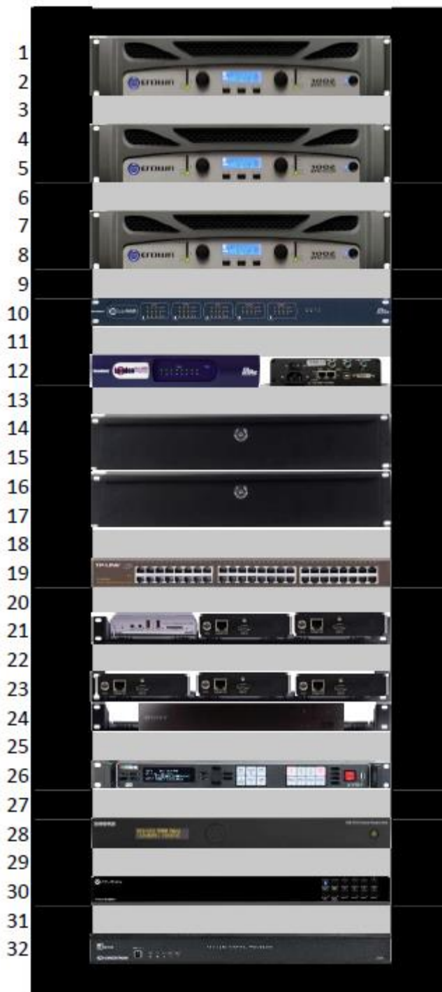
Figura 79. Vista frontal del rack
