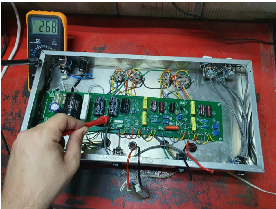
Figura 4-6. Medición de voltaje en el tercer condensador de filtro.
