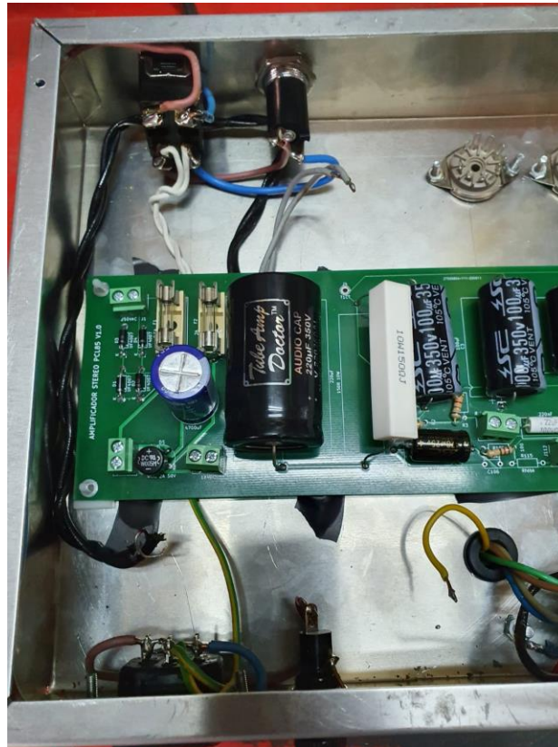
Figura 3-21. Detalle del conexionado del primario del transformador.
