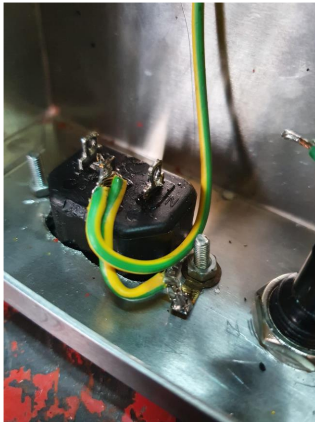
Figura 3-20. Detalle de la conexión a tierra del chasis.
