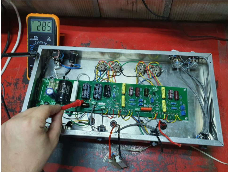
Figura 4-5. Medición de voltaje en el segundo condensador de filtro.
