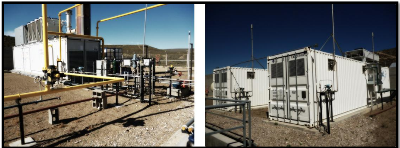
Ilustración 4. Electrolizadores y grupo electrógeno de 1,4 MW. Fuente: HYCHICO
