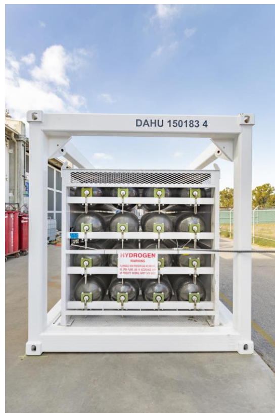
Ilustración 33: Sistema de almacenamiento de hidrógeno comprimido en el RSOFC de la marina de los EE.UU
