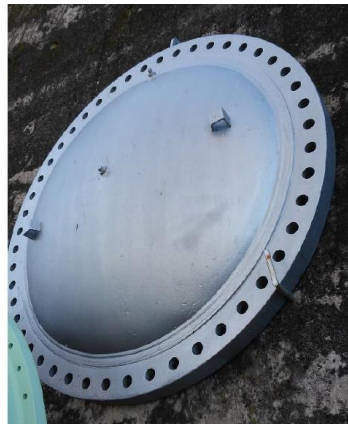
Figura 2-14: Tapa ciega de la tubería forzada de la Central de Guillena.
