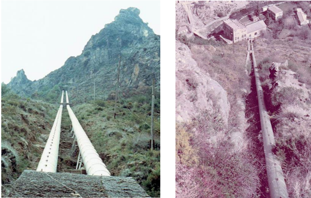
Figura 2-15: Tubería forzada de la Central de Pinos Genil. Fuente: Ramón Abella Monserrat
