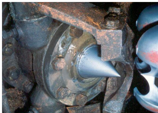
Figura 4-4: Deflector y aguja del rodete Pelton de la Central de Izbor. Fuente: Ramón Abella Monserrat.
