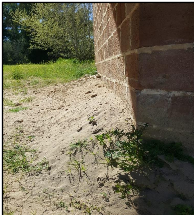
Figura 4-9: Arena acumulada en las pilas del puente
