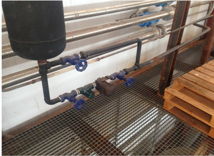
Ilustración 8-1. Tuberías conducción del vapor.
