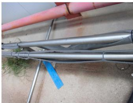
Ilustración 7-3. Tuberías con aislamiento deteriorado
