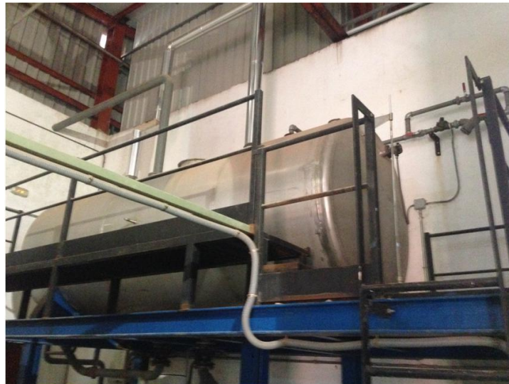
Ilustración 8-2. Caldera de vapor.
