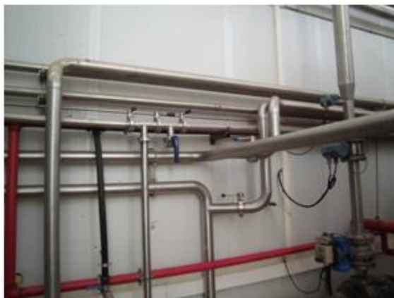
Ilustración 7-1. Tuberías del circuito de frío.
