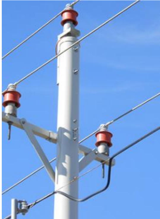
Figura 2-4. Soporte de línea aérea en baja tensión
