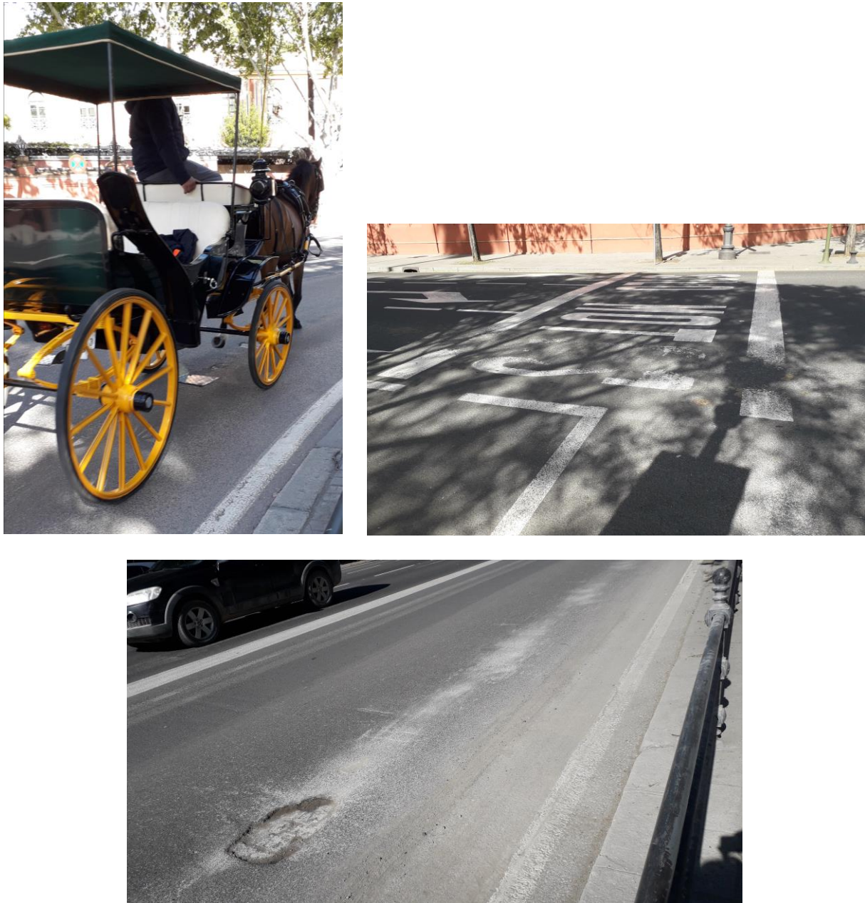
Figura 5-8. Deterioro del pavimento originadas por caballos, incluso desaparición de señalización horizontal (c/ Palos de la Frontera).
