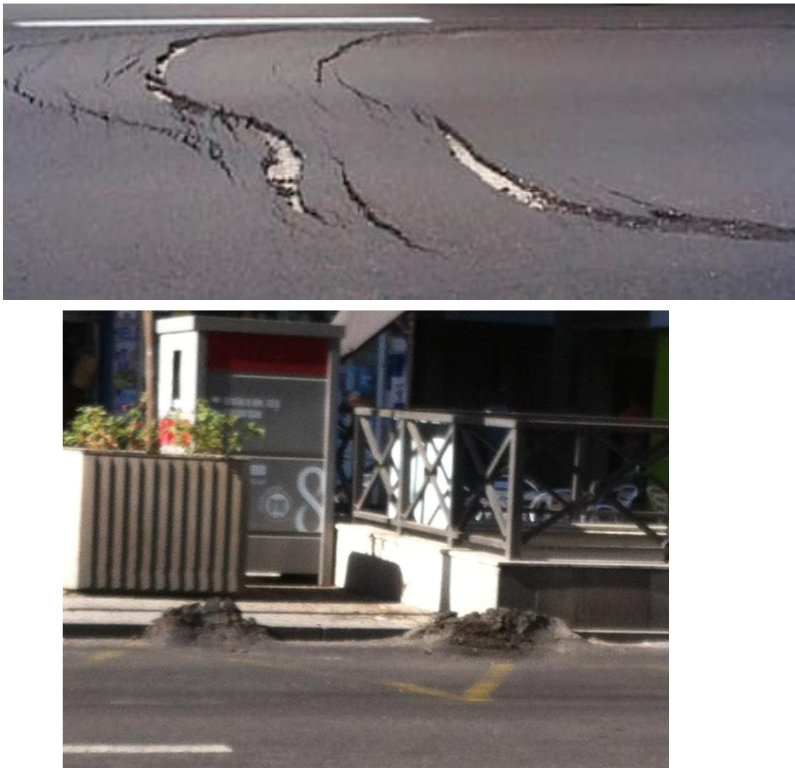
Figura 3-3. Deformación plástica generada por esfuerzos horizontales
