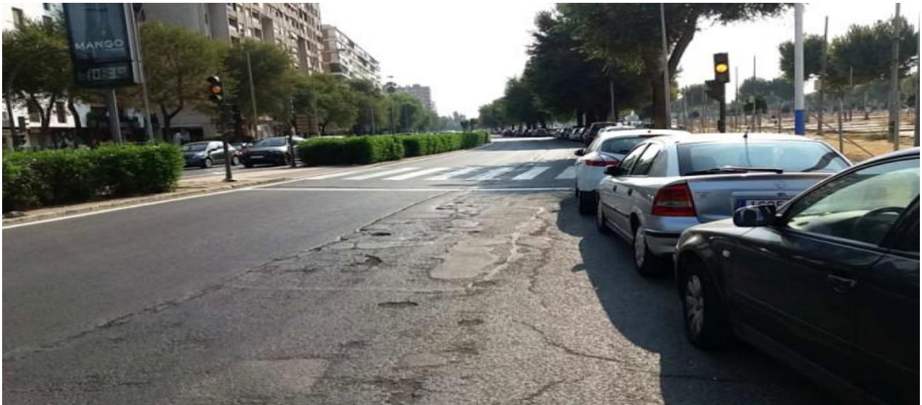
Figura 3-2. Deformación plástica generada por mala dosificación de la mezcla
