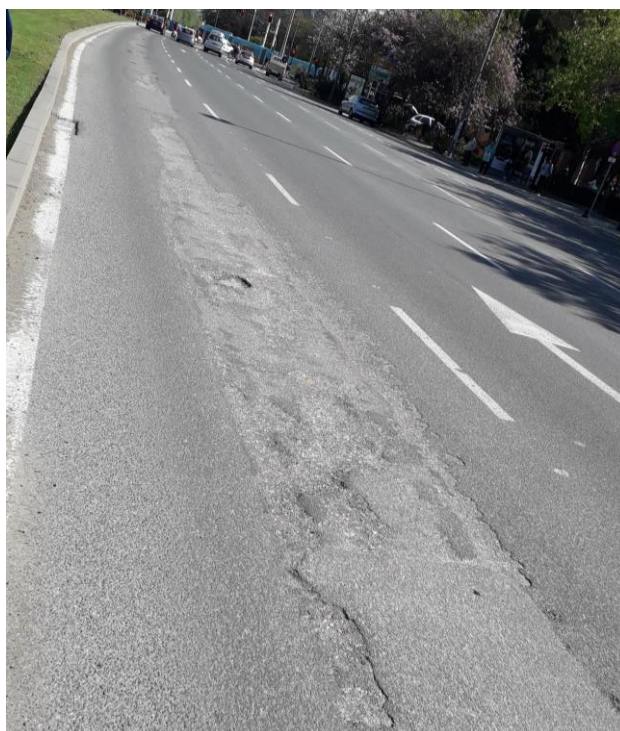
Figura 5-10. Deterioro del pavimento originadas por caballos (Av/ El Cid)
