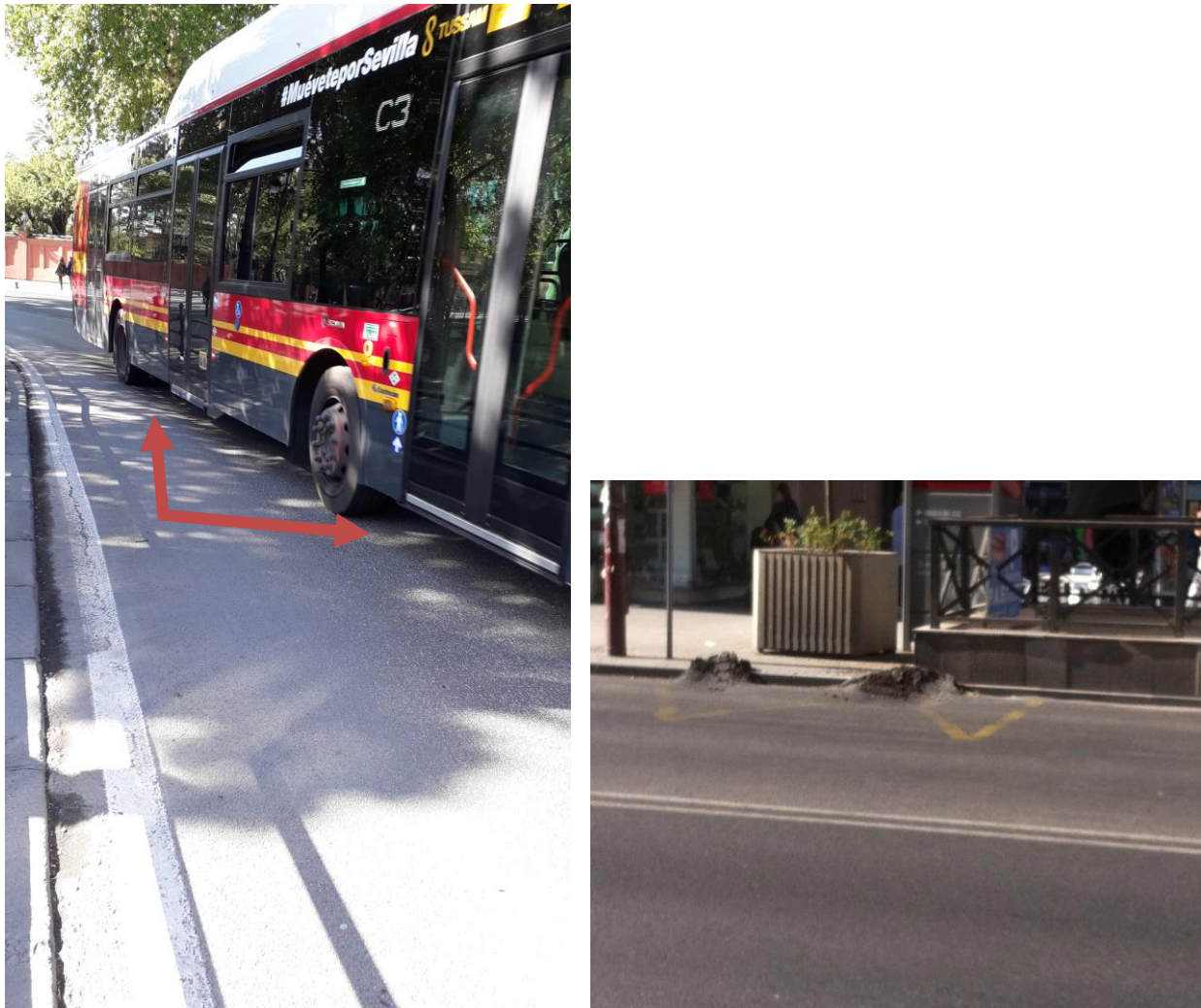
Figura 5-1. Deformaciones-roderas originadas por la rodadura de autobús (c/Palos de la Frontera y c/Virgen de Luján).
