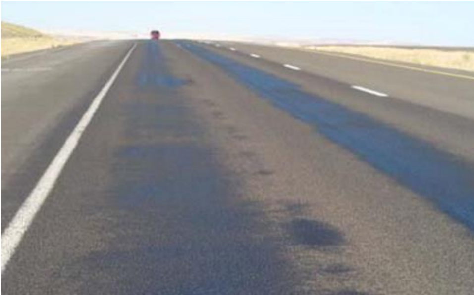
Figura 5-4. Exudación por exceso de betún
