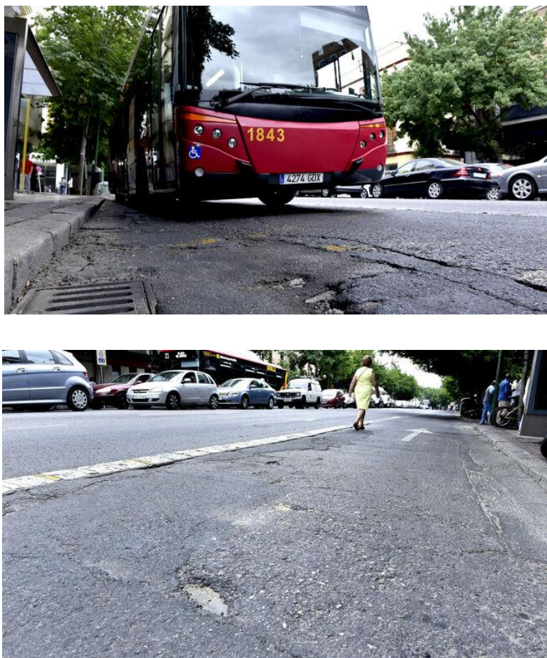
Figura 5-5. Deformaciones, fisuras y baches por pérdida de capacidad portante en parada de bus (Av/ Menéndez Pelayo)
