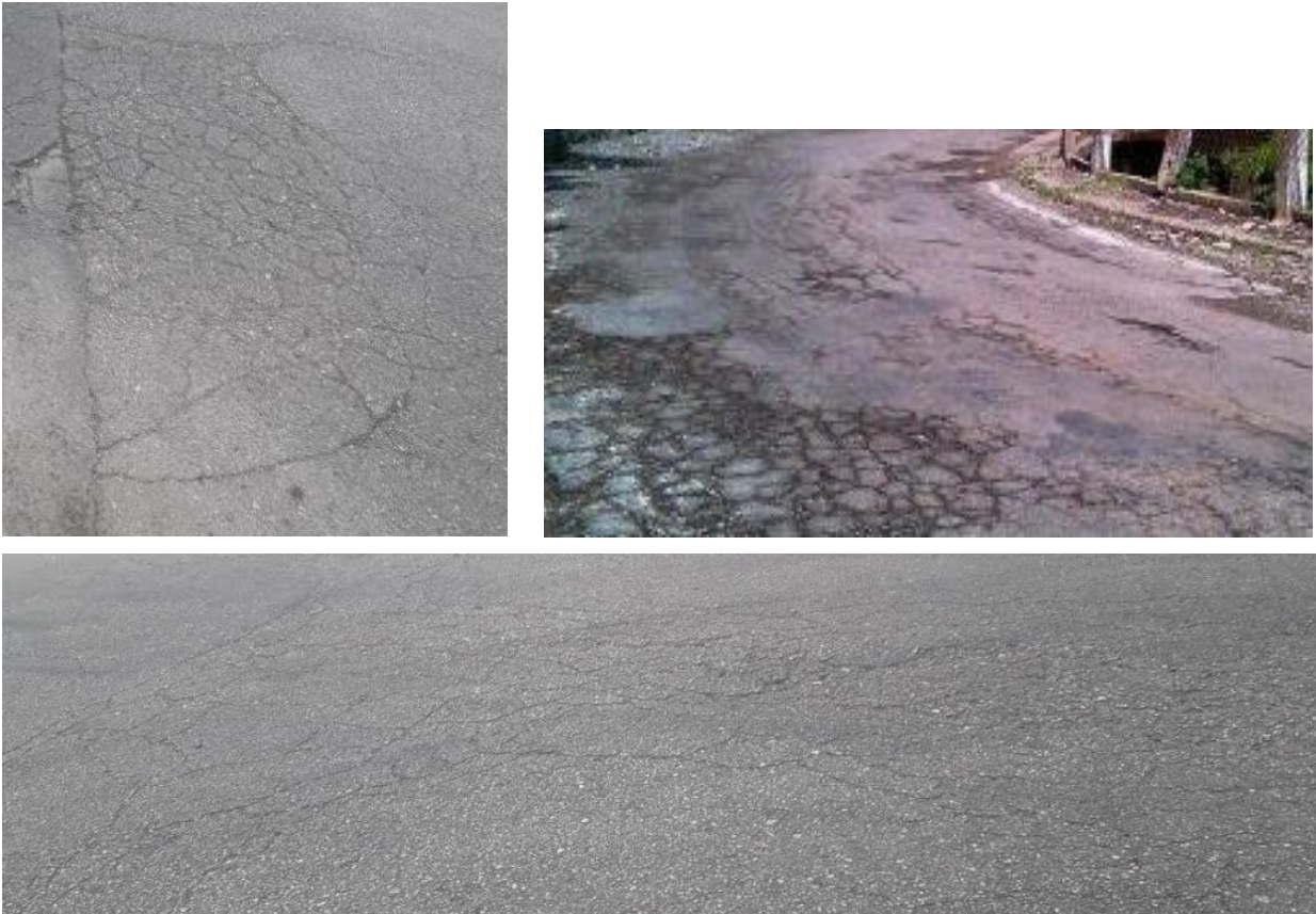
Figura 3-4. Fisuración pavimento por fatiga, conocida como “piel de cocodrilo”
