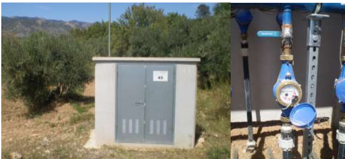
Fotografía 5.1. Caseta de agrupación y detalle de un contador volumétrico instalado
