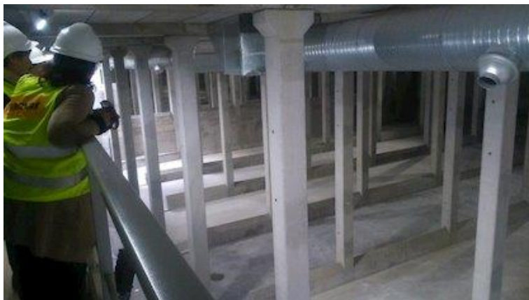
Imagen 8. Depósito subterráneo de pluviales en Avda. Kansas City. Sevilla (EMASESA)
