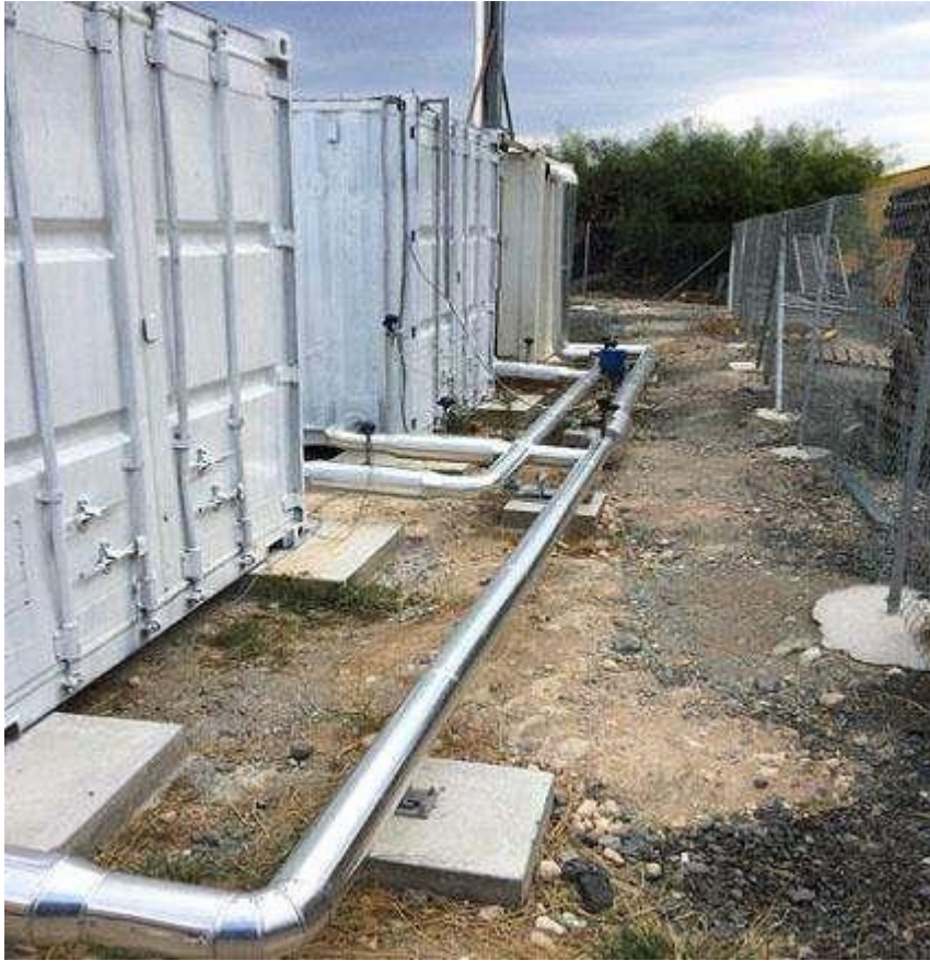
Figura 47: Sistema de almacenamiento SolidTES. [51]
