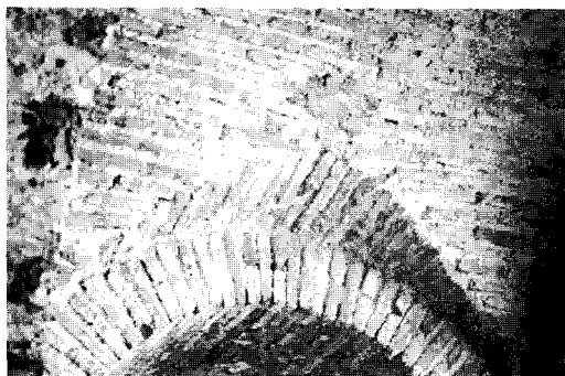
Figura 2 Solución de la galería mediante intersección de bóvedas en el Cuartel de la Puerta de la Carne de Sevilla
