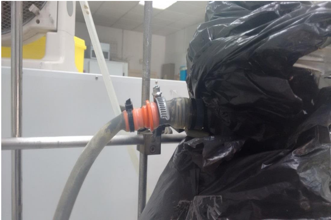
Figura 28: Imagen de la salida de recirculación en el digestor (Fotografía: Antonio José Alonso).
