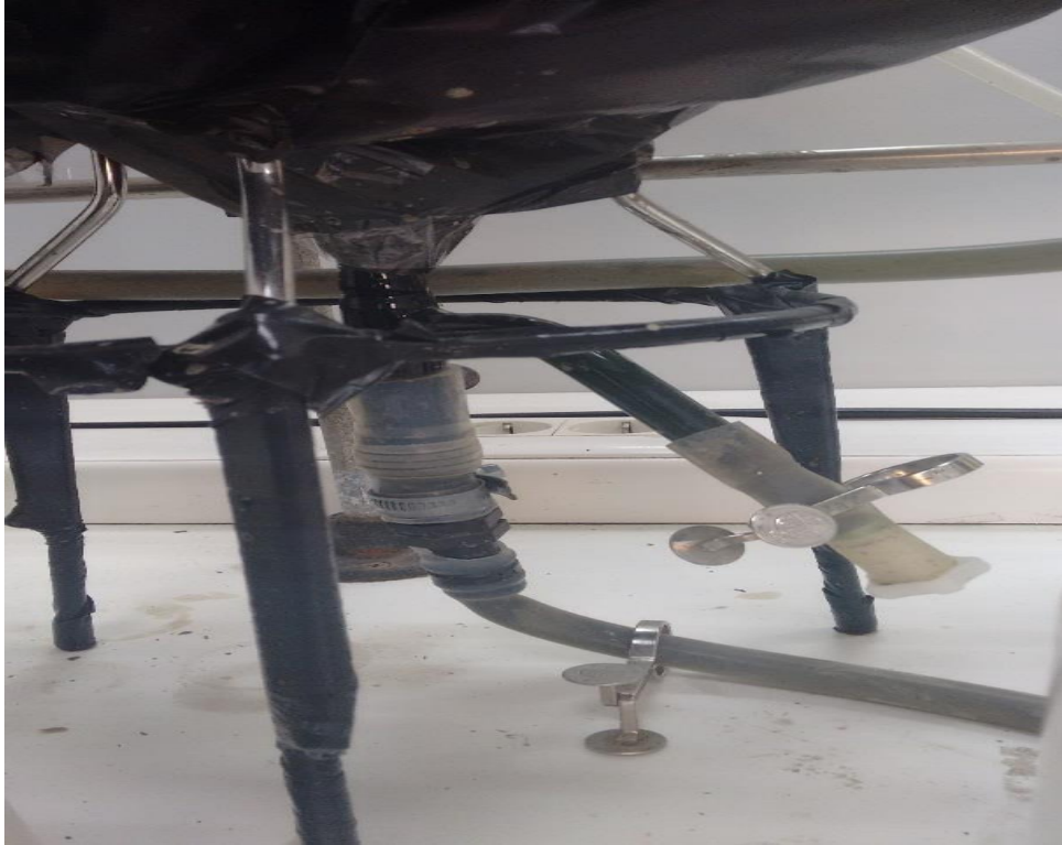
Figura 29: Imagen de la entrada de recirculación en el digestor (Fotografía: Antonio José Alonso).
