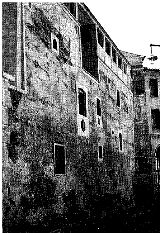
Figura 3 Huecos abiertos en la muralla de Alcoy
