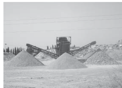
Figuras 3.20-3.22. Instalaciones de la planta de ALCOREC de San José de la Rinconada
