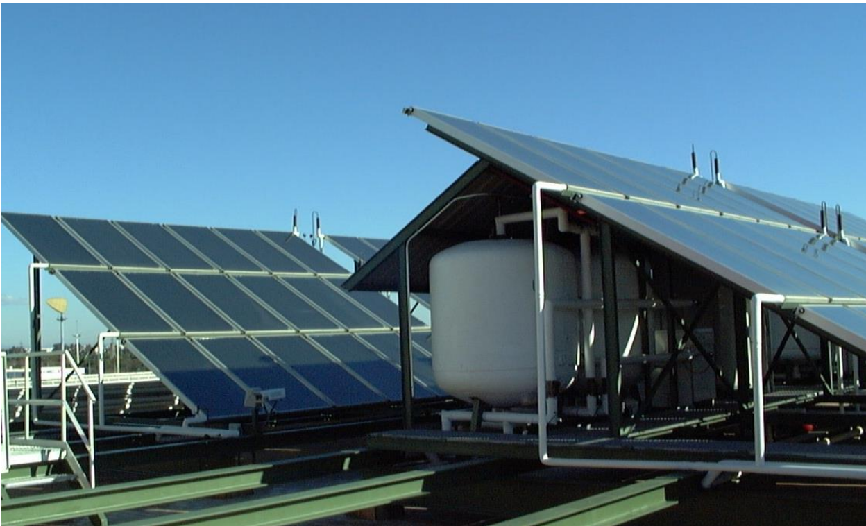
Ilustración 5: Instalación solar situada en los laboratorios de la ETSI
