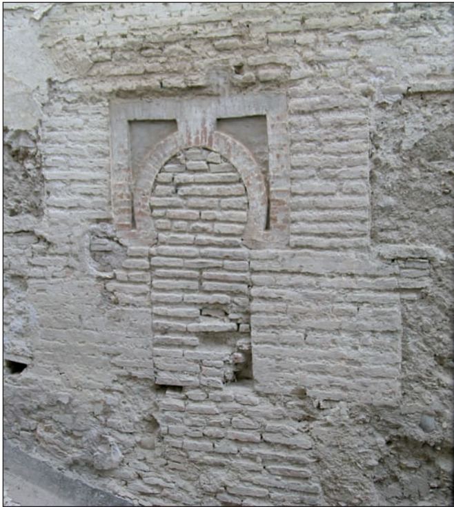
Fig. 22. Detalle del vano mudéjar identificado en la cara exterior del muro oriental de la iglesia.
