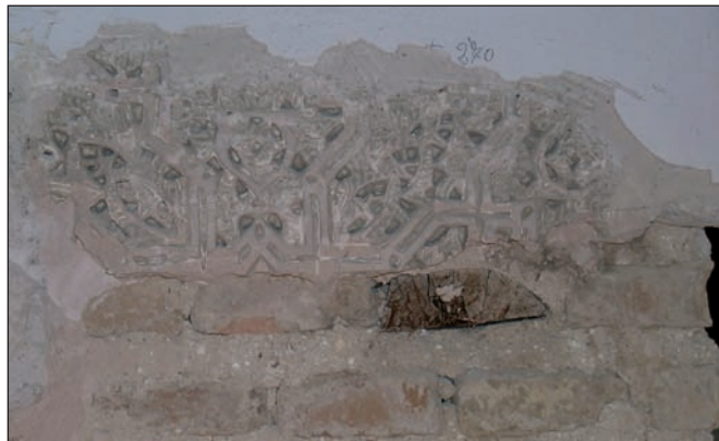
Fig. 13. Detalle de la yesería del testero septentrional del recinto palatino, actualmente localizado en la planta superior de la estancia 7
