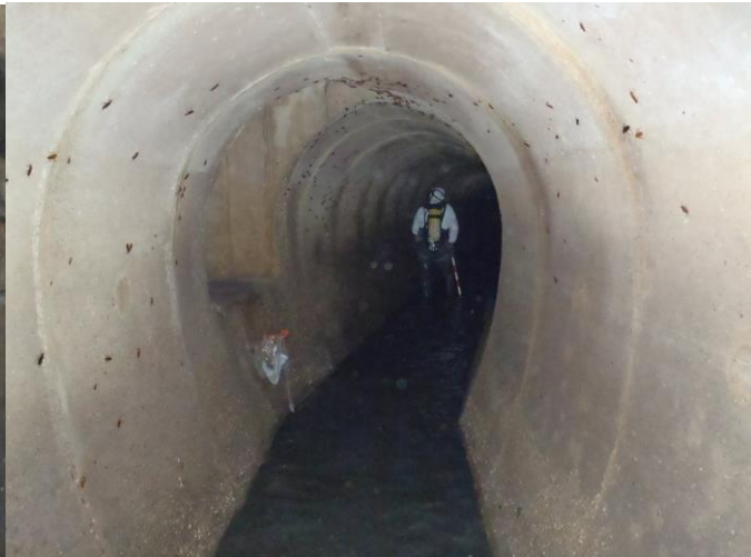
Figura 2-4. Cucarachas en las paredes.
