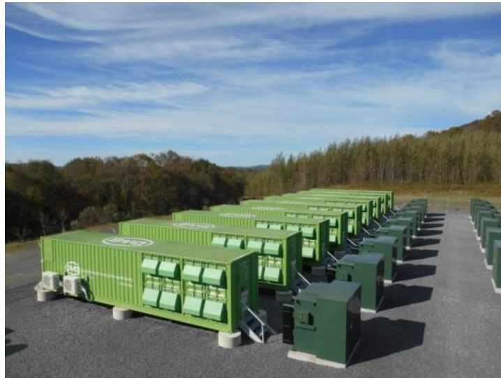
Figura 2.6. Sistema de Almacenamiento de la Planta Eólica de Grand Ridge en la localidad de Marseilles, Condado de La Salle (Illinois, USA). [32]
