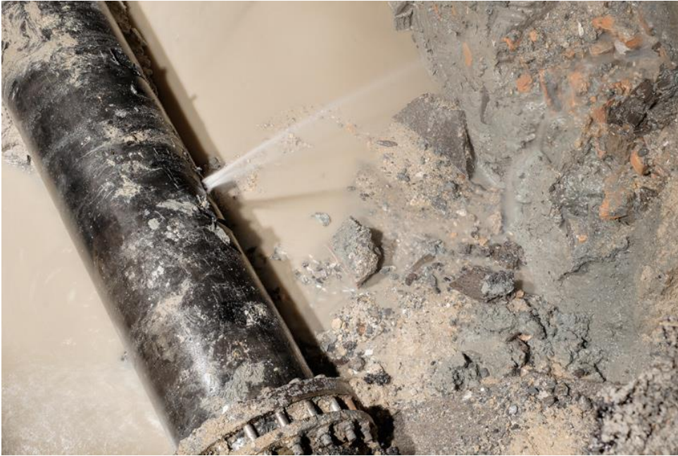
Figura 1-10: Fuga en tubería subterránea. (Fuente: Página web es.123rf.com)
