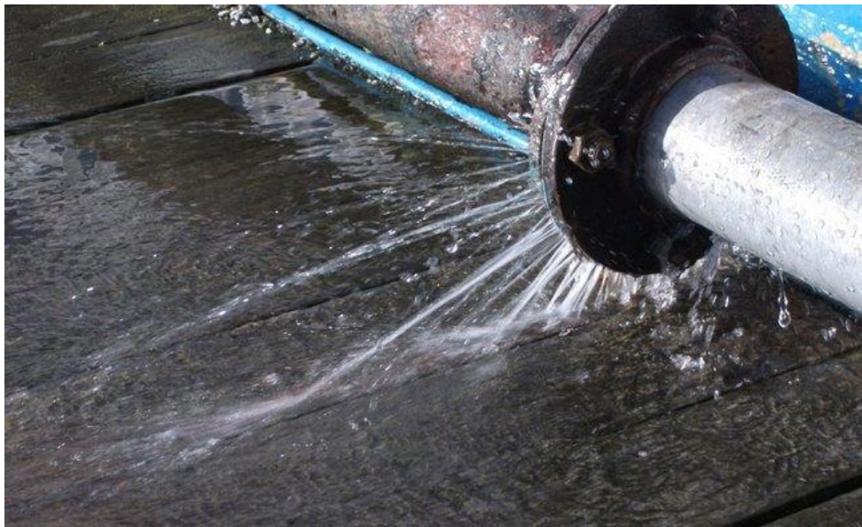
Figura 1-8: Fuga en unión de tuberías. (Fuente: Página web plomerosenmonterrey.com)
