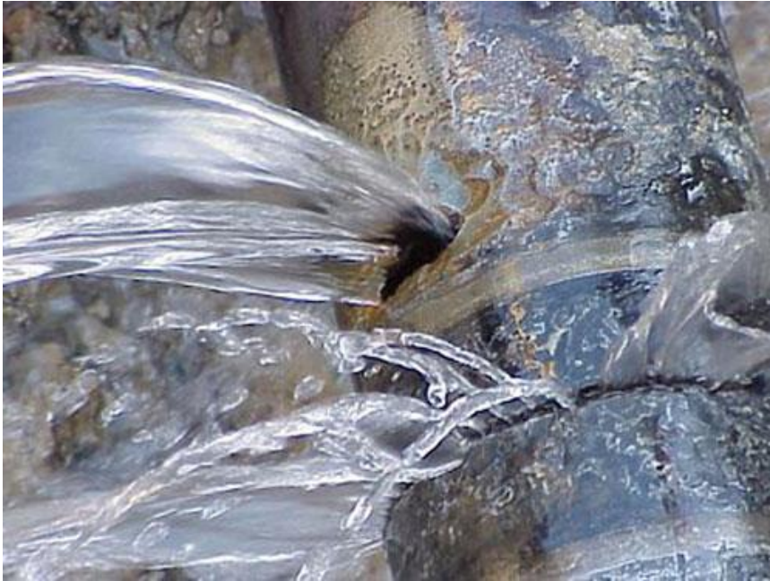
Figura 2-3: Orificio perforado en tubería. (Fuente: Página web todofugas.com)
