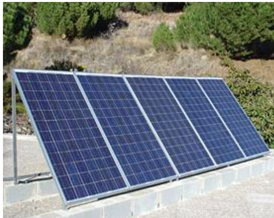
Figura 4.6: Generador solar fotovoltaico sobre suelo
