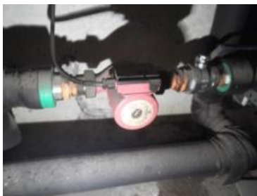
Bomba del circuito secundario:
