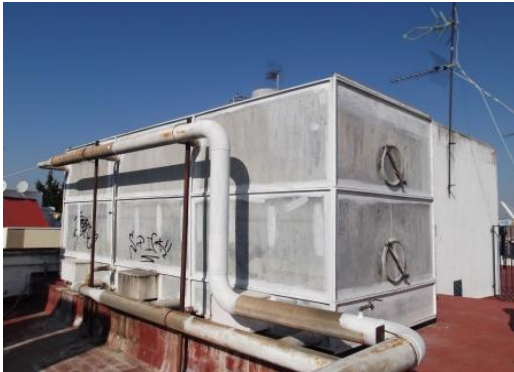
1.14 Torre de refrigeración
