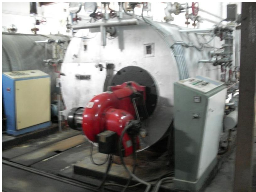
Figura 1.7 Generador de vapor n°2.
