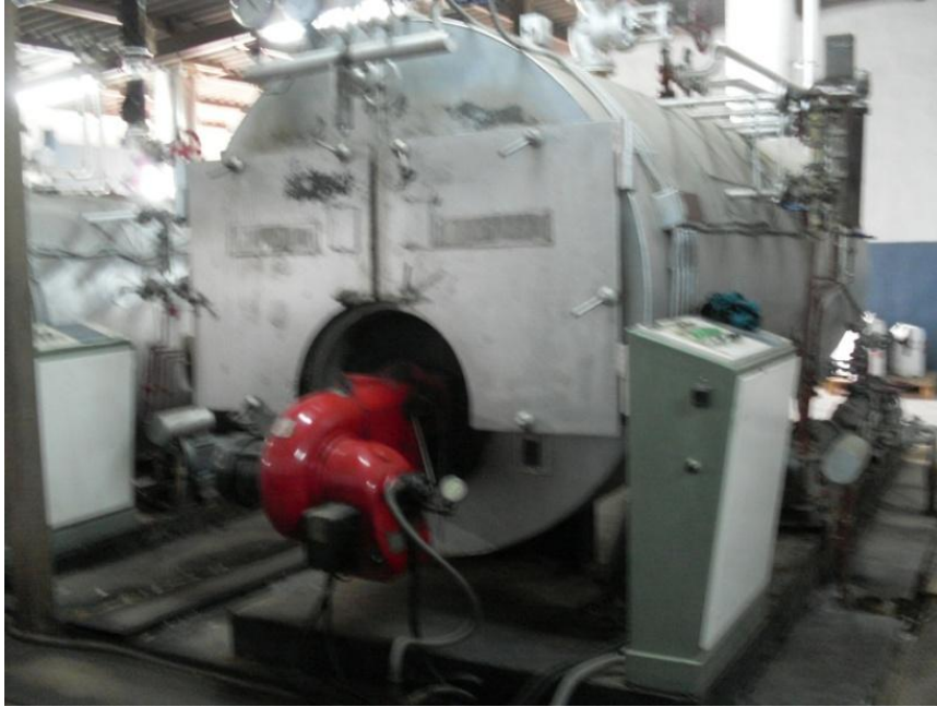
Figura 1.6 Generador de vapor n°1.
