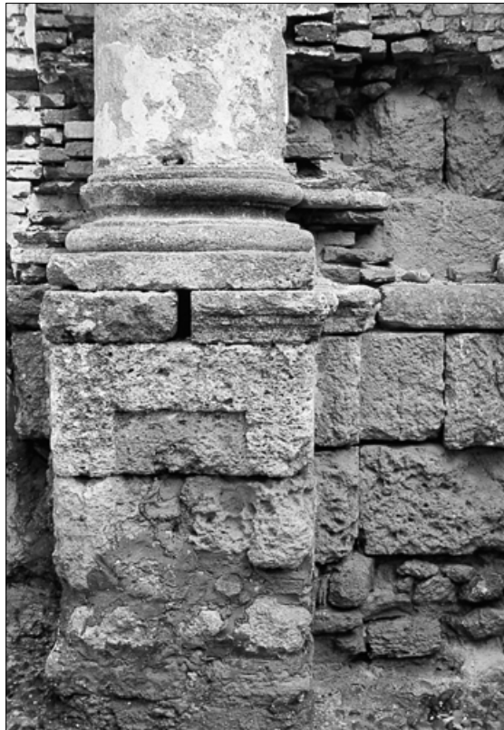
Fig.1 Aspecto del alto grado de alteración de la piedra y reparchos de intervenciones recientes
