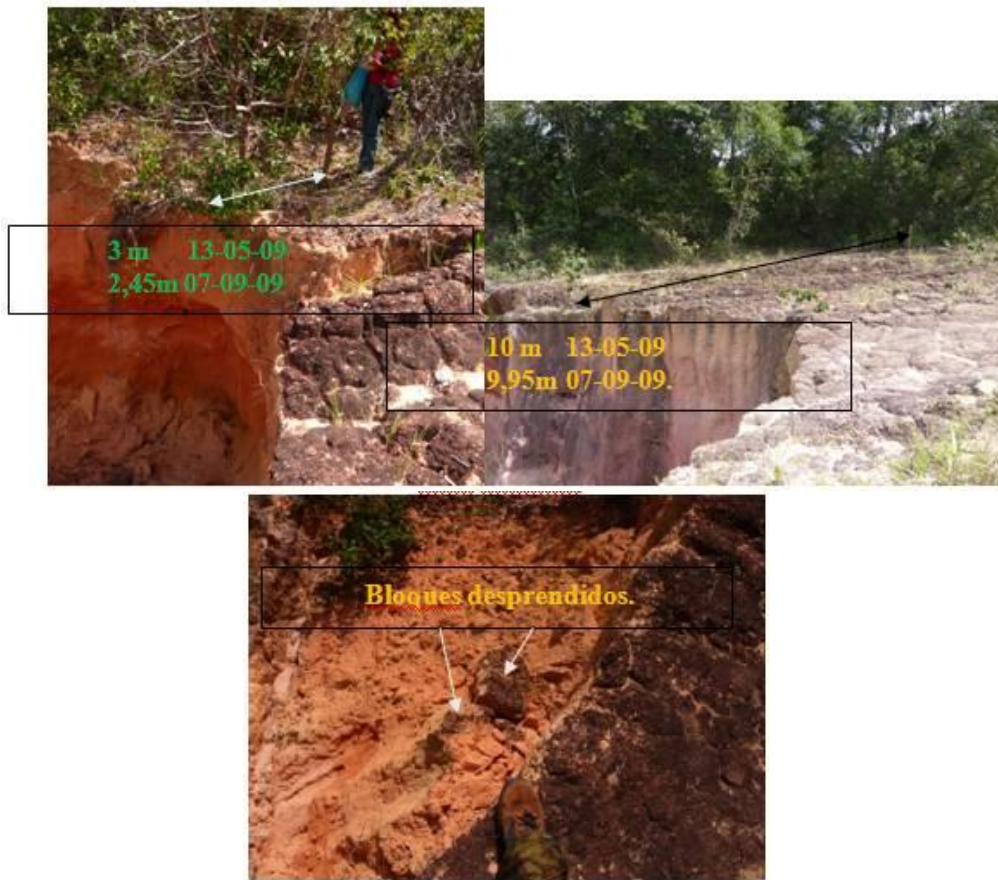
Fotos 2. Estacas colocadas ao redor da voçoroca desenvolvida sobre a estrada e blocos desprendidos dentro da mesma (Bilal Paladini, 2009).
