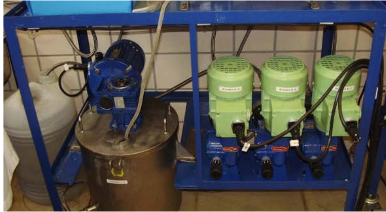
Figura III.89. Vista del tanque de preparación de la solución orgánica extractante y bombas del sistema de extracción líquido-líquido
