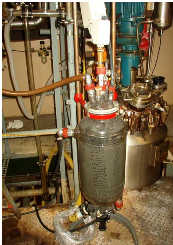
Figura III.65. Reactor de dosificación (R-4) de la salida del reactor de lixiviación
