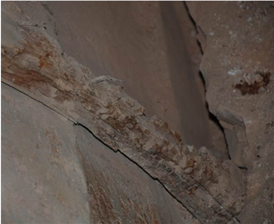
Vista del reverso de una de las bóvedas de la Alhambra, donde se aprecian zonas con pudrición | foto Fondo Gráfico IAPH (Marta Sameño Puerto)
